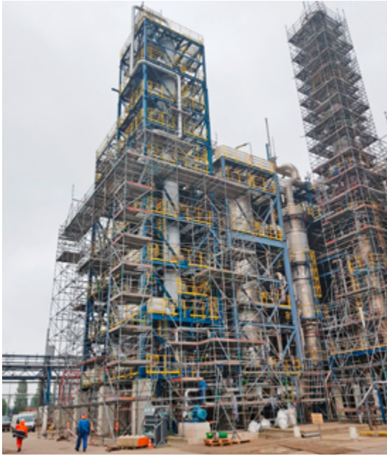
De nieuwe crystalizer van Delamine die 2020 is geplaatst.
