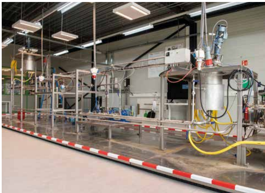
In deze proeffabriek werken bedrijven en onderwijsinstellingen onder begeleiding van World Class Maintenance aan het voorspelbaar maken van onderhoud in de (petro)chemie.
